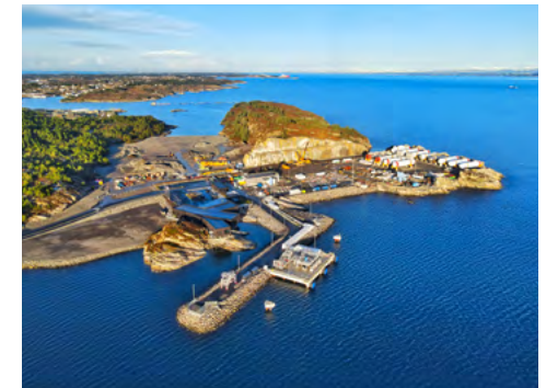
Construction du terminal de réception, stockage et pompage du CO 2 de Northern Lights, à Øygarden (Norvège).
